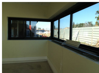
C'est d'ici que se feront les contrôles d'accès des véhicules.
