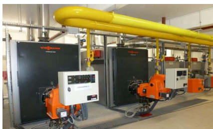
Les 3 nouvelles chaudières
